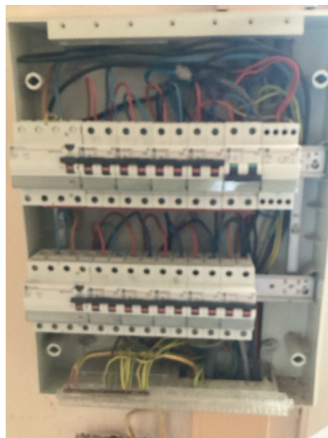
( Elektrisch bord - binnenkant )
