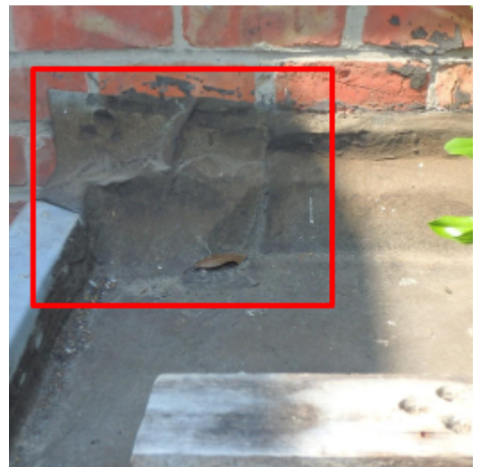
dak [5]: slordige muuraansluiting
