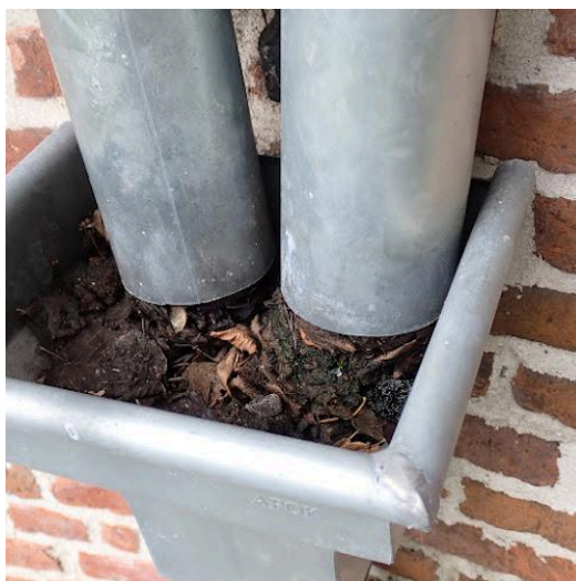
dak [1]-zuid: verstopte vergaarbak en afvoer konden niet vrijgemaakt worden
