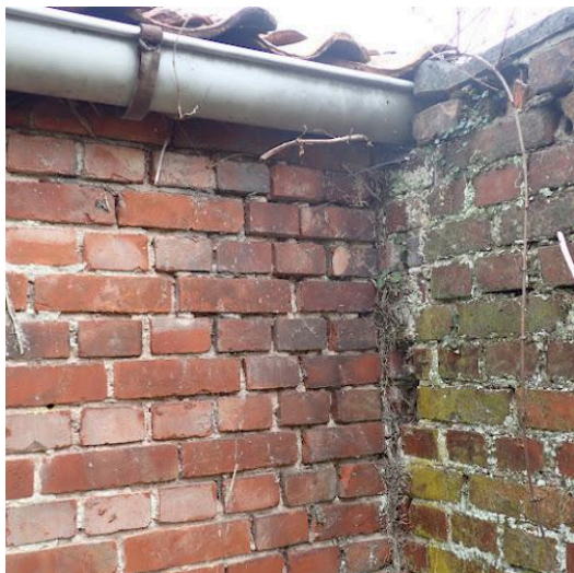
vleugel [4]-zuid: uitgespoeld voegwerk
