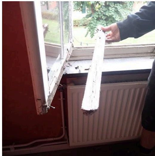
vleugel [1]: weggefallen waterlijst
