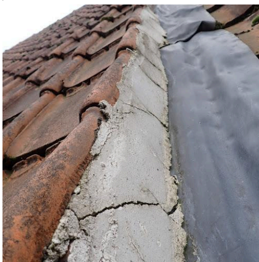
dak [1]-noord: mortelaansluiting scheurt en valt weg
