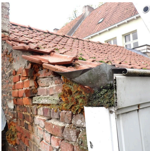
vleugel [3]: niet afgewerkte kopse opstand
