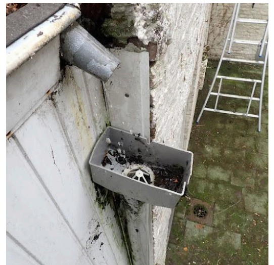
vleugel [3]: beschadigd tapstuk, weggevallen afvoer en beschadigde vergaarbak
