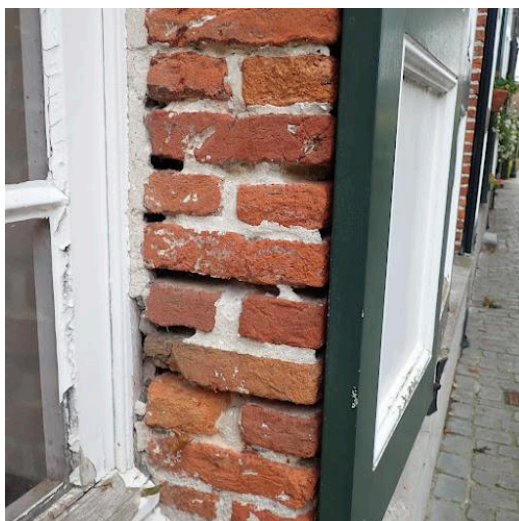
vleugel [1]-zuid: uitgespoeld voegwerk
