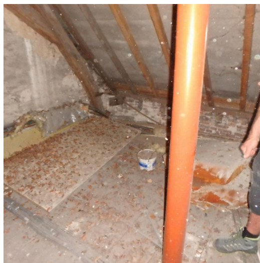
zolder [1]: de zolder is vervuild
