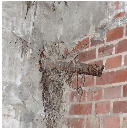
vleugel [4]-oost: een roestig muuranker is aanwezig maar de strijk balk is weg
