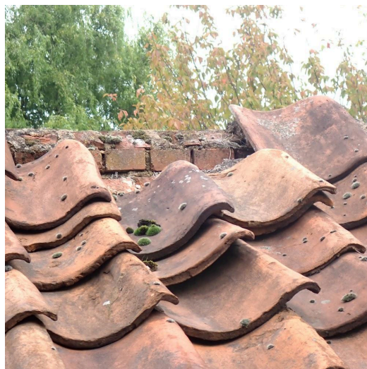
Dak [4]: uitgeschoven pannen en weggefallen mortelaansluiting
