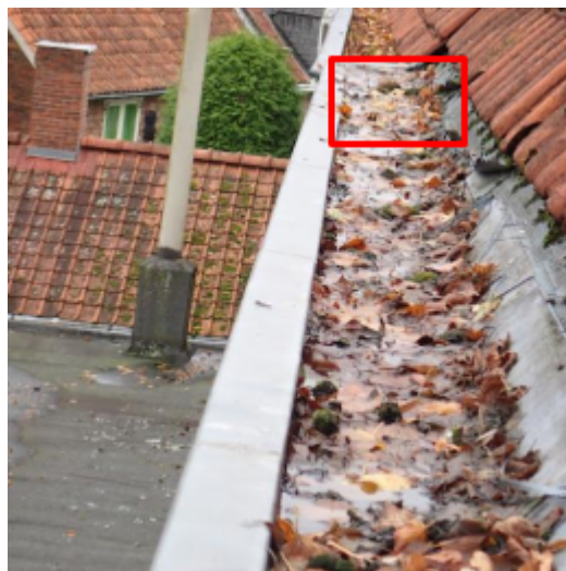
dak [1]-noord: het tapgat is verstopt en de goot loopt over, het tapgat werd vrijgemaakt
