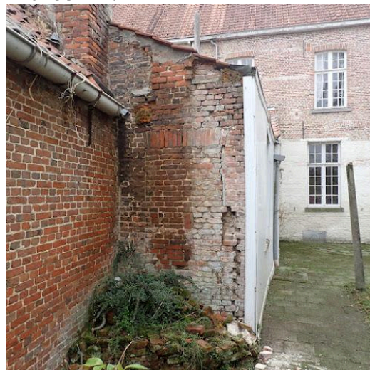
vleugel [3]-noord: ingescheurde en verzwakte muur
