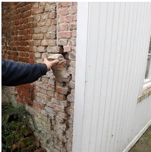
vleugel [3]-noord: stenen liggen los en vallen weg
