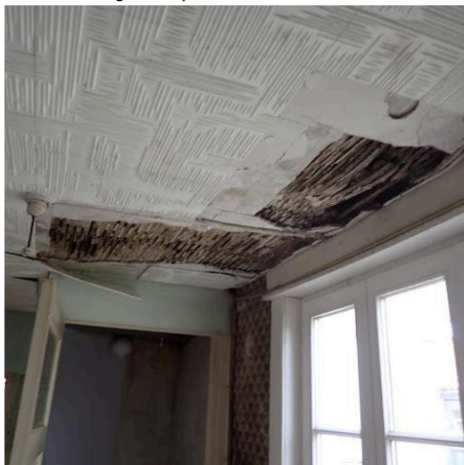
weggefallen plafondtegels, verzakte en ingerotte tengellatten
