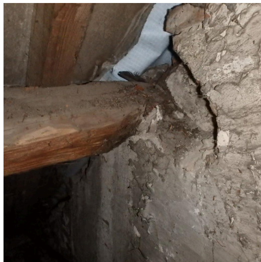
dak [1]: ingerotte oplegging
