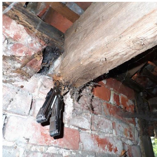
dak [4]: ingerotte balkkop
