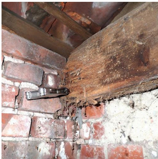
dak [4]: ingerotte balkkop
