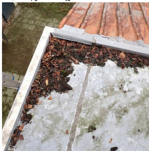
dak [2]: het dak is beperkt vervuild
