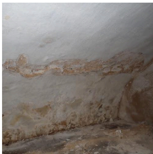
pleister door vocht beschadigd
