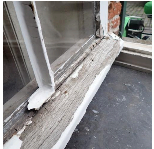
weggefallen stopverf en verdwenen schilderwerk
