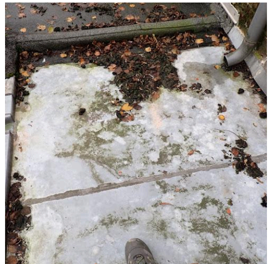
dak [2]: sterk verweerd zink en het bolt op
