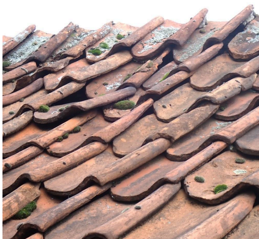
Dak [4]: verzakte pannen door...
