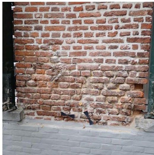
vleugel [1]-zuid: uitgespoeld voegwerk
