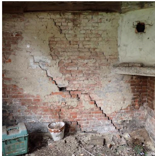
vleugel [4]-west: sterke zettingsscheur
