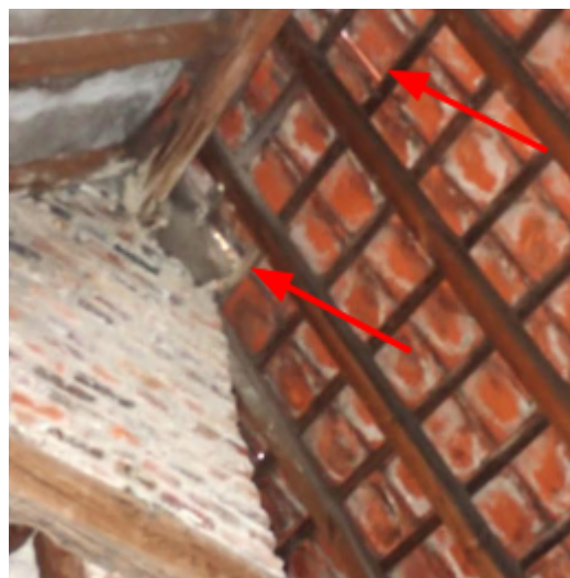
dak [1]-noord: de pannen sluiten onderling niet goed aan
