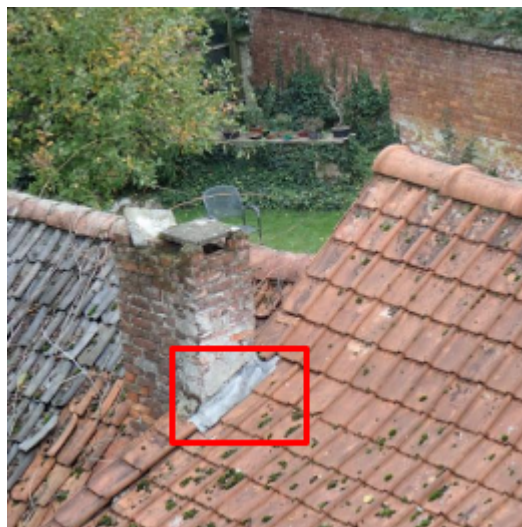
noordelijke schoorsteen: de loodaansluiting komt los
