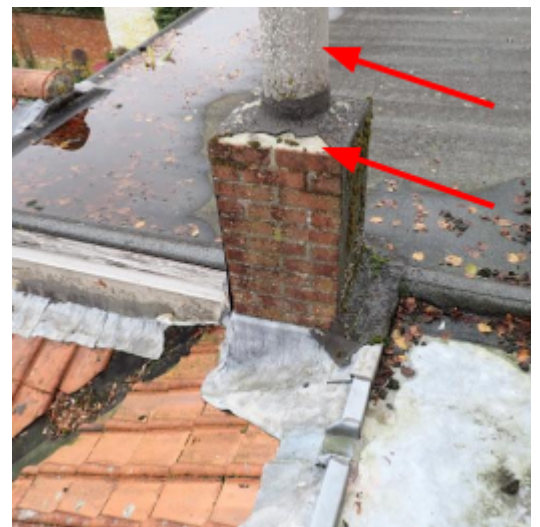
zuidelijke schoorsteen: beschadigde roofing en asbestbuis
