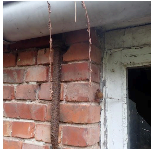
vleugel [4]: roestig muuranker
