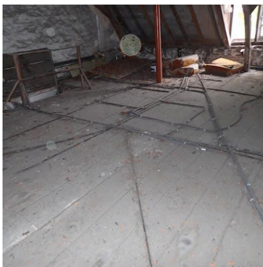
leidingen liggen kriskras op de zoldervloer
