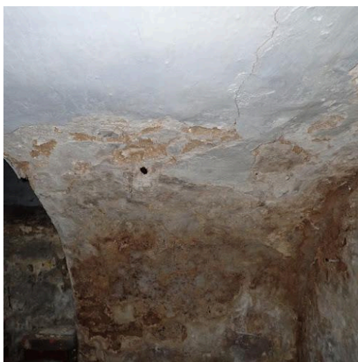
pleister door vocht beschadigd
