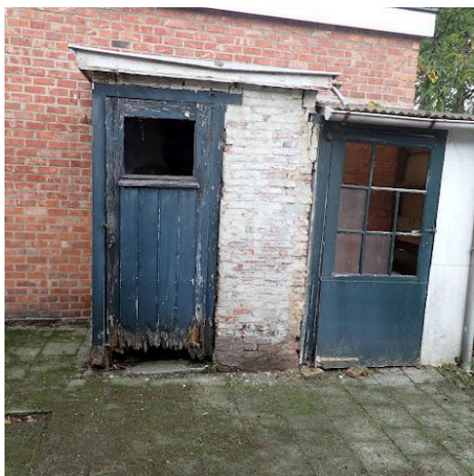
vleugel [5]: ingerotte deur
