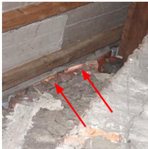
dak [1]-zuid: westelijke dakaansluiting slordig afgewerkt met lichtinval
