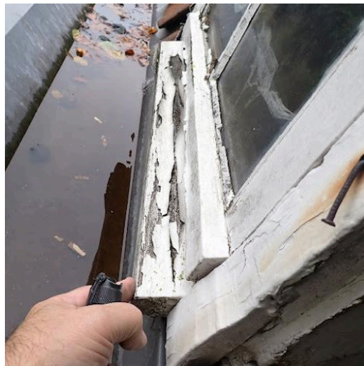
ingerot hout en afbladderende verf
