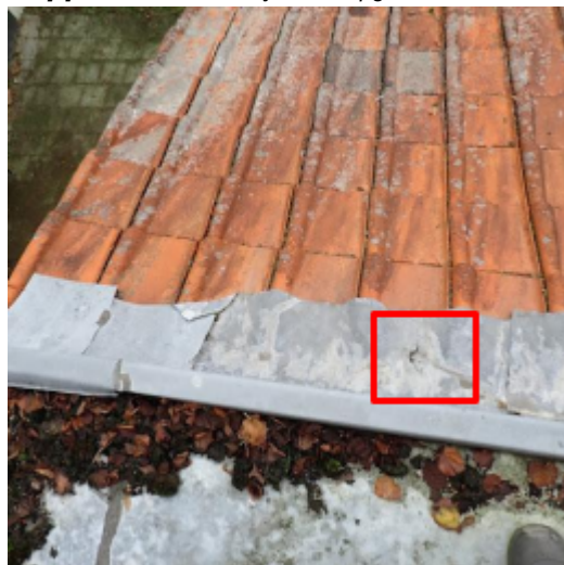
dak [3]: de zink- en loodslabben zijn slordig geplaatst en stuk verweerd
