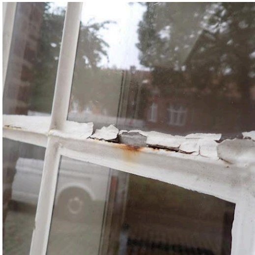
roestige raamverdeling en weggefallen stopverf
