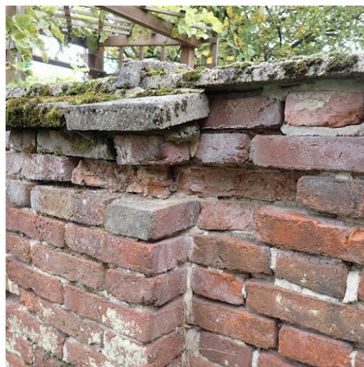
door vocht en vorst beschadigde stenen en uitgespoeld voegwerk
