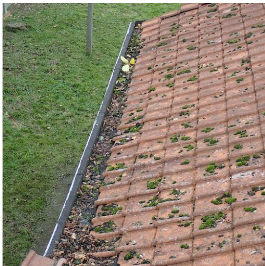
dak [3]: vervuilde goot
