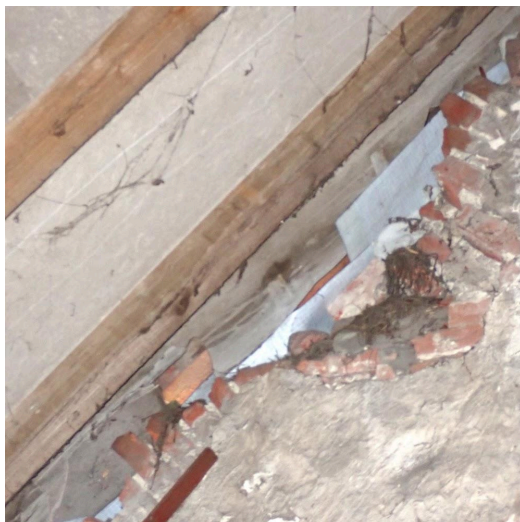
dak [1]-zuid: westelijke dakaansluiting slordig afgewerkt
