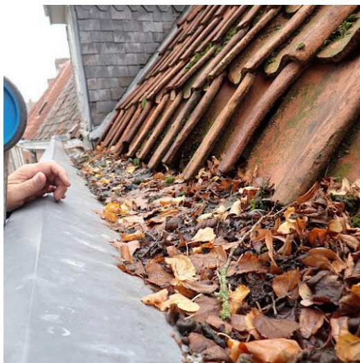
dak [1]-zuid: sterk vervuilde goot
