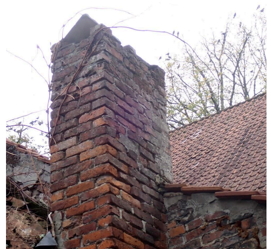
noordelijke schoorsteen is instabiel
