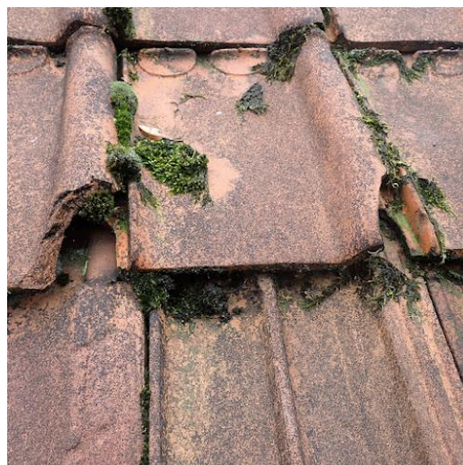
dak [1]-noord: afgebroken stukken pan
