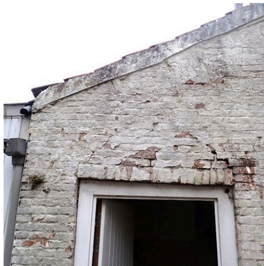
vleugel [3]-west: ingescheurd en verzakt steenwerk
