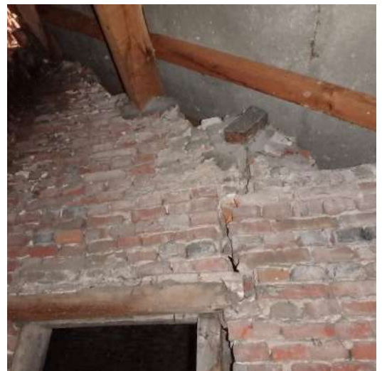
zolder [1]-oost: sterk scheurvorming en verzwakt steenwerk
