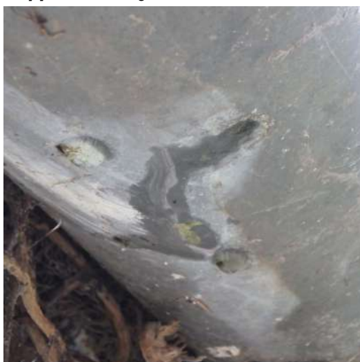
dak [4]: de goot vertoont enkele verweringsgaten
