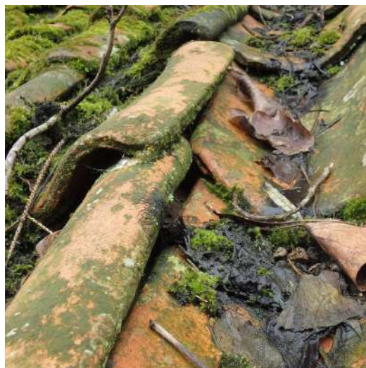
dak [4]: slechte onderlinge aansluiting
