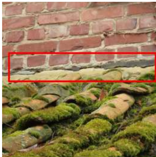
dak [4]: stuk verweerde roofingaansluiting
