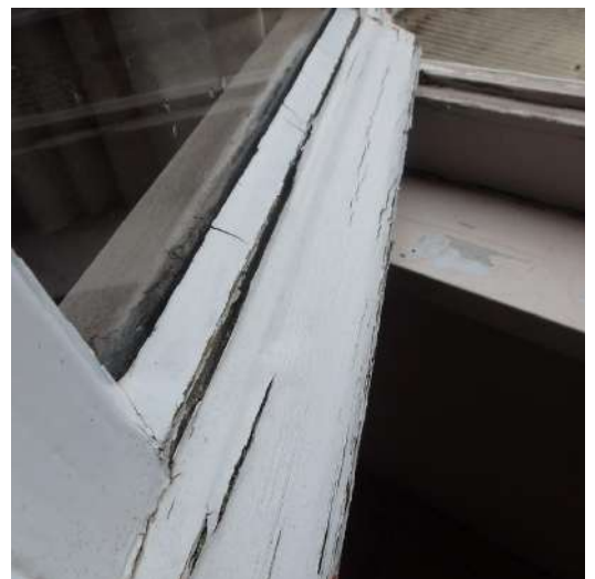
losgescheurde stopverf en afbladderend schilderwerk
