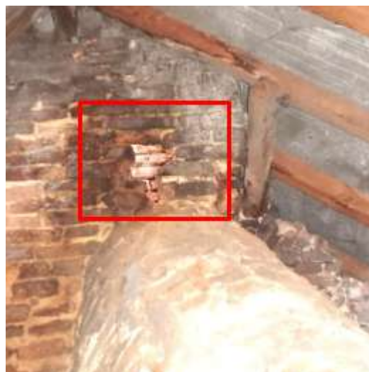
bovenste deel is grotendeels weggevallen
