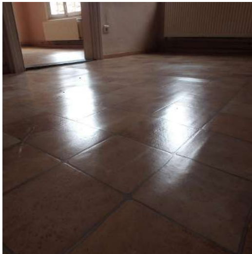
de afwerking verhindert een controle van de verzakte vloer
