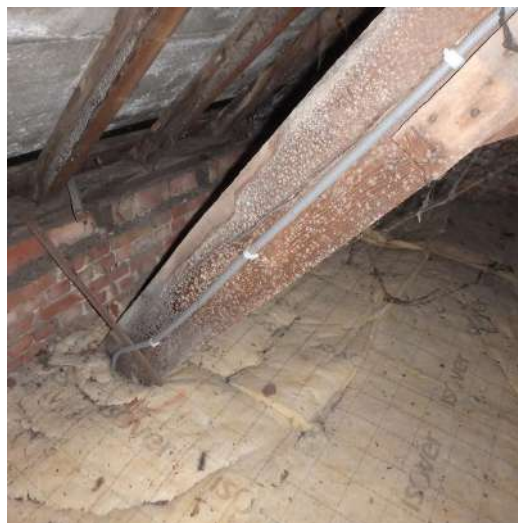
sterk beschimmelde dakconstructie
