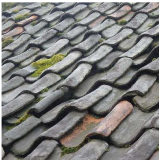
dak [1]: sterk verweerde en geklonken pannen
