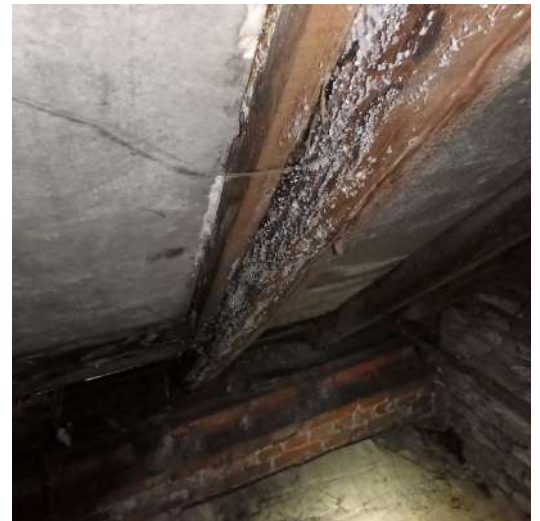
sterk beschimmelde dakconstructie
