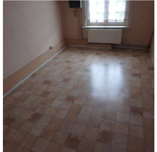
de afwerking verhindert een controle van de verzakte vloer
