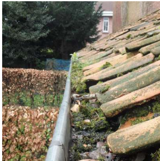
dak [4]: de goot is sterk vervuild
