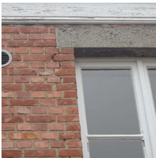
vleugel [2]: scheurvorming tussen twee verschillende materialen
