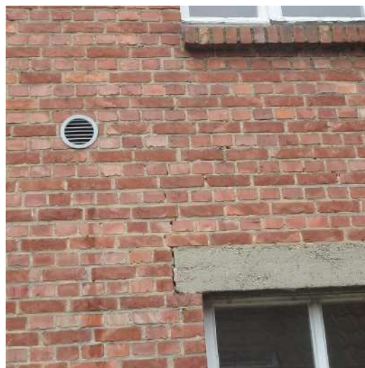
vleugel [2]: scheurvorming tussen twee verschillende materialen
