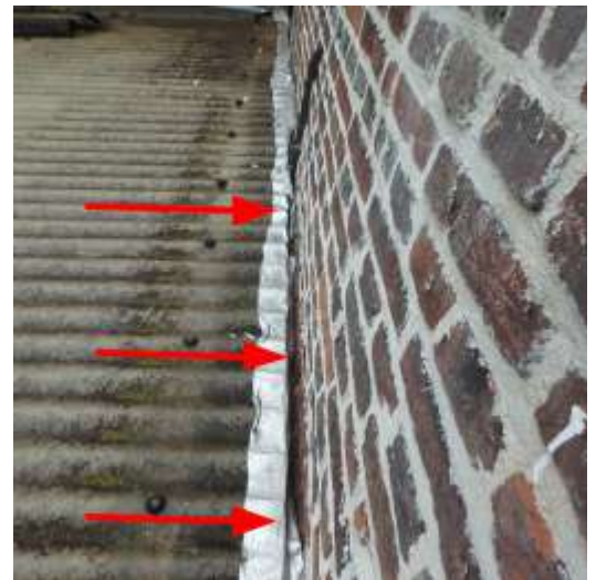
de bitumentape aansluiting is lek
