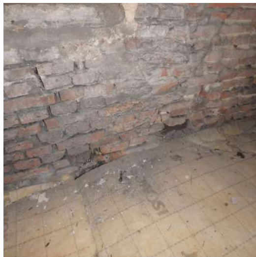
zolder [1]: zones uitgespoeld voegwerk
