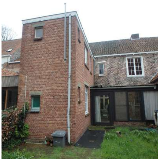
dak [2]: de afvoer buigt en...
