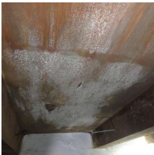
sterke schimmelvorming op het plaatmateriaal
