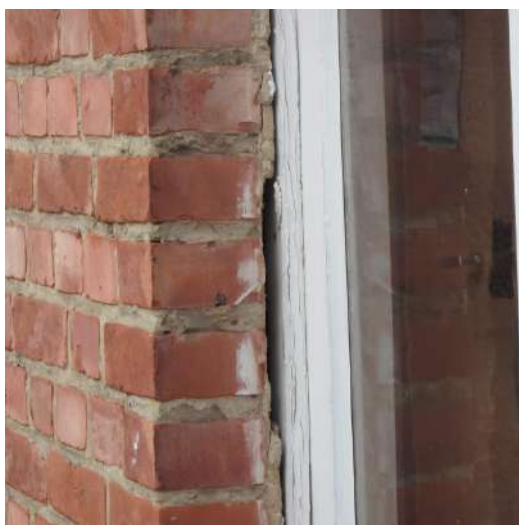
vleugel [2]: weggefallen mortel in de dagkant
