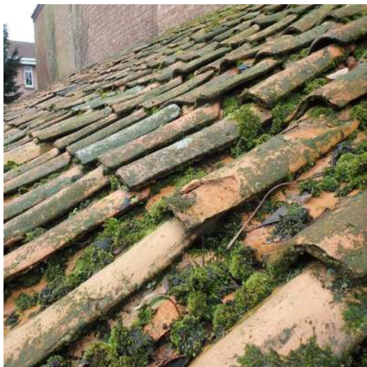
dak [4]: sterk verweerde en beschadigde pannen
