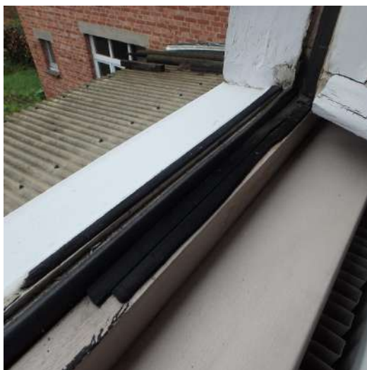
raam niet wind- en regendicht
