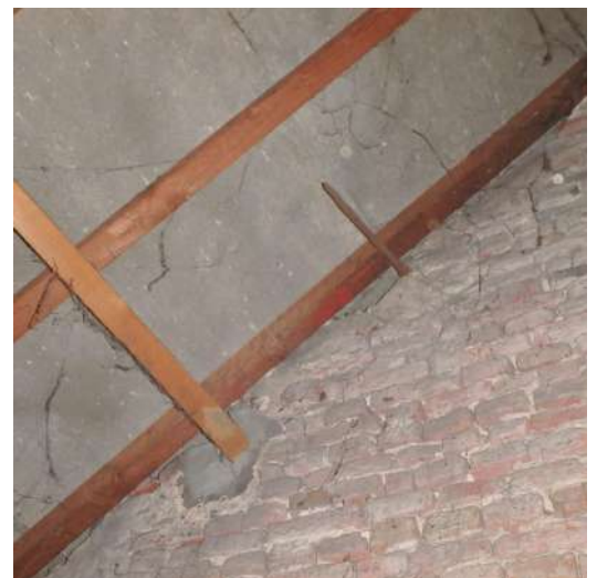
nieuwe gordingen zijn niet verankerd
