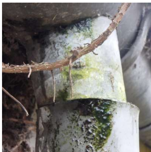
dak [4]: de afvoer is uitgezakt
