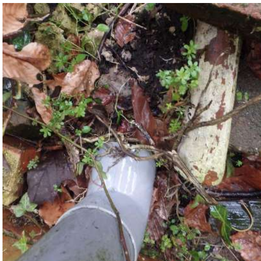
dak [4]: de afvoer loost het water tegen de gevel
