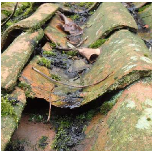
dak [4]: stuk verweerde pan
