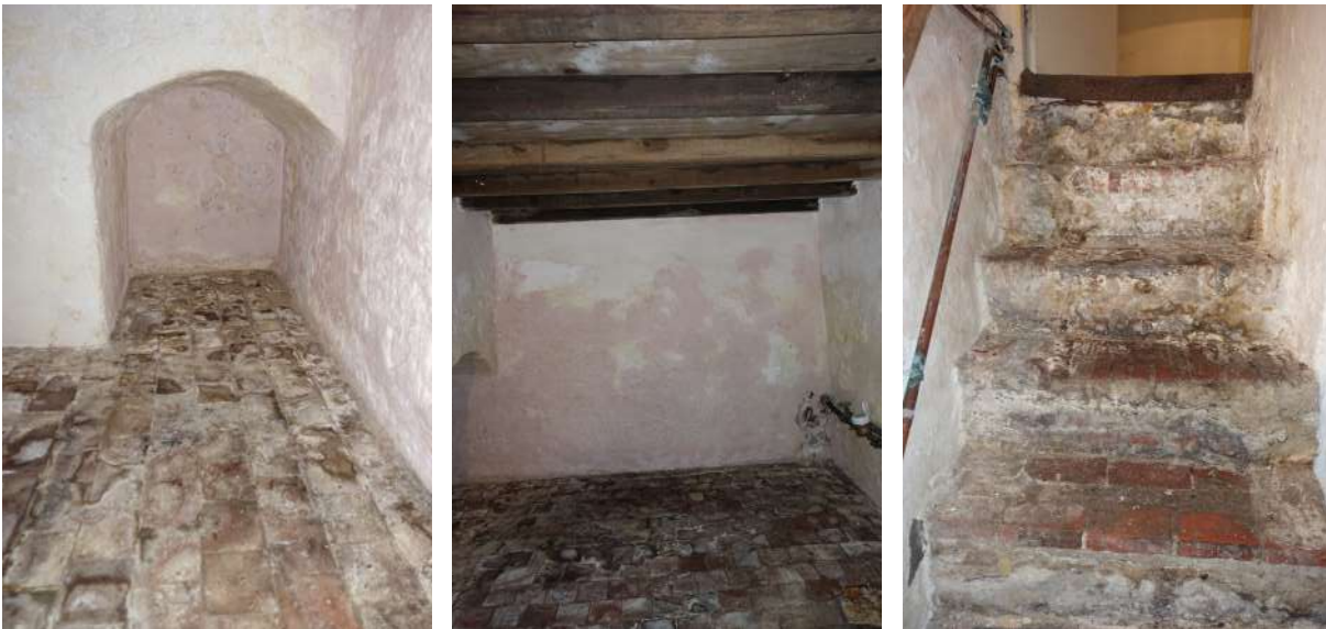
afb. 76: Details van de kelder met vochtproblemen, huidige toestand 2024.
