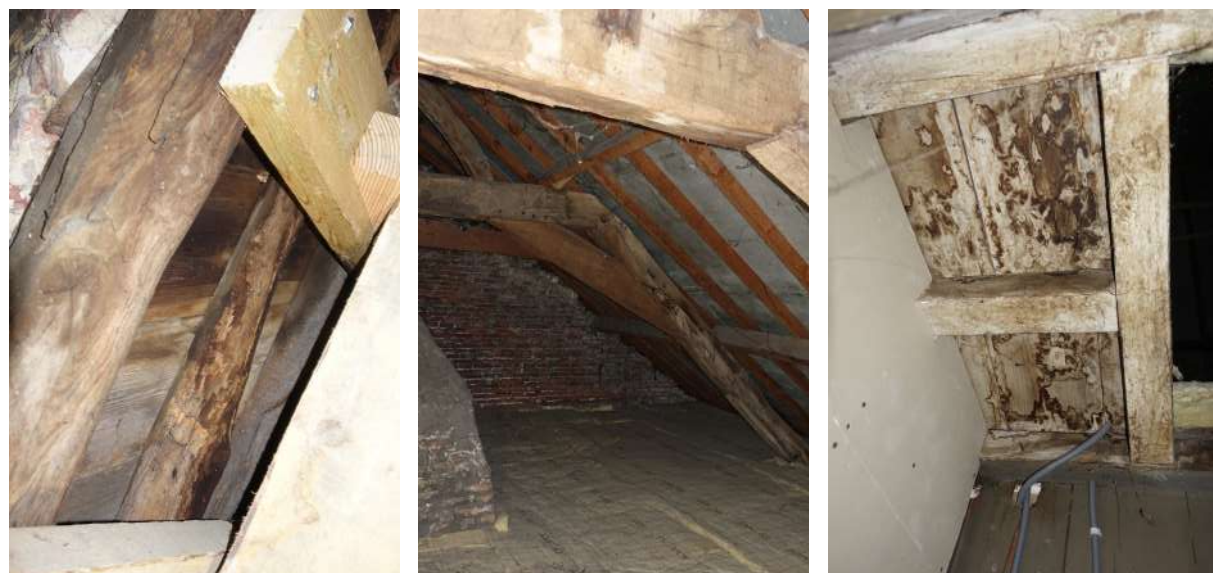
afb. 73: Zolder met dakgebinte, details aangetast hout, huidige toestand 2024.
