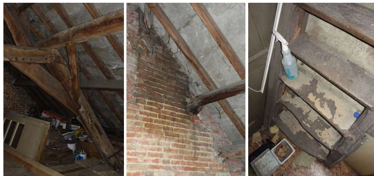
afb. 74: Zolder met dakgebinte, aangetast en ingerot hout en zoldertrap, huidige toestand 2024.
