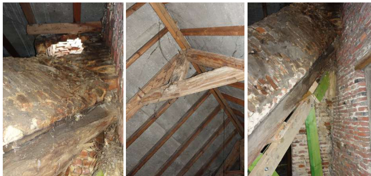
afb. 72: Zolder met dakgebinte, details schouwen en aangetast hout, huidige toestand 2024.
