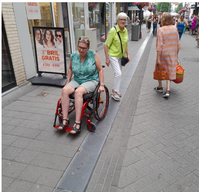
Het hoogteverschil tussen het voetpad en de weg is belemmerend. Een effen wegdek is een voordeel.
