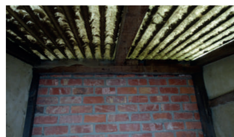
afb. 68: Plafondafwerking balken (links) en storende afwerking met golfplaten (rechts)
