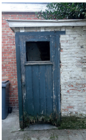
afb. 66: Beschadigde deur toiletkotje.
