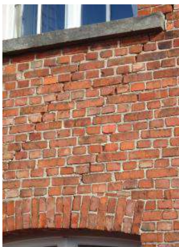
Afbeelding 59: Scheuren onder het raam
