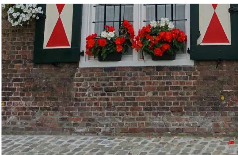
Afbeelding 55: Detail van de vervuiling
