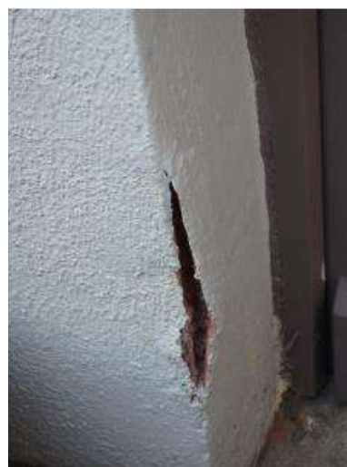
Afbeelding 61: Gebarsten pleisterwerk van de aanbouw
