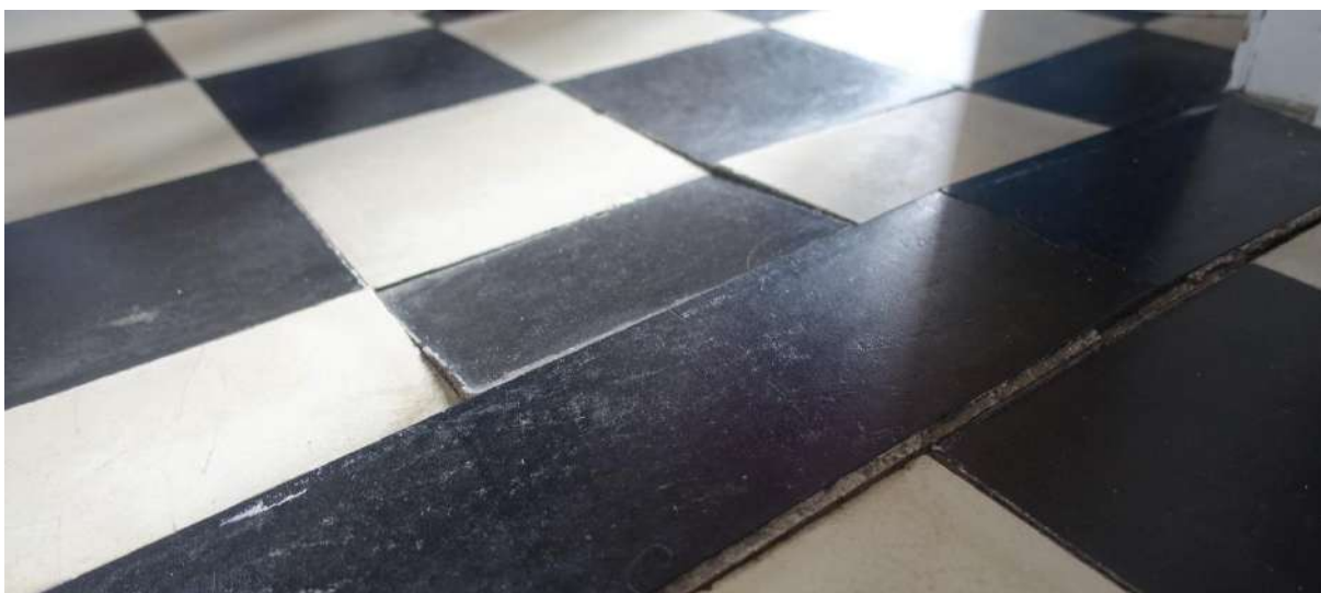
Afbeelding 71: Detail van de schade aan de vloer
