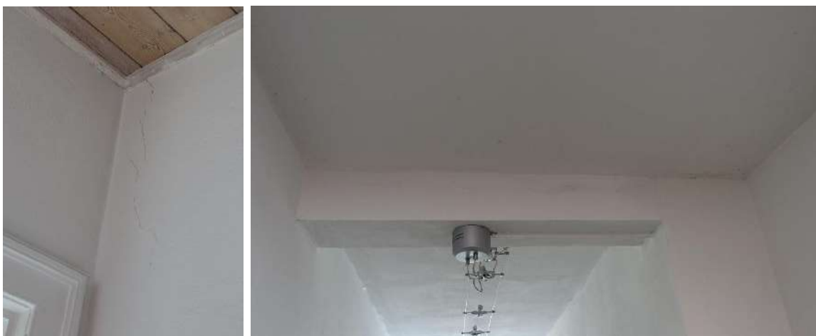
Afbeelding 67: Scheur in de muur langs de gang
