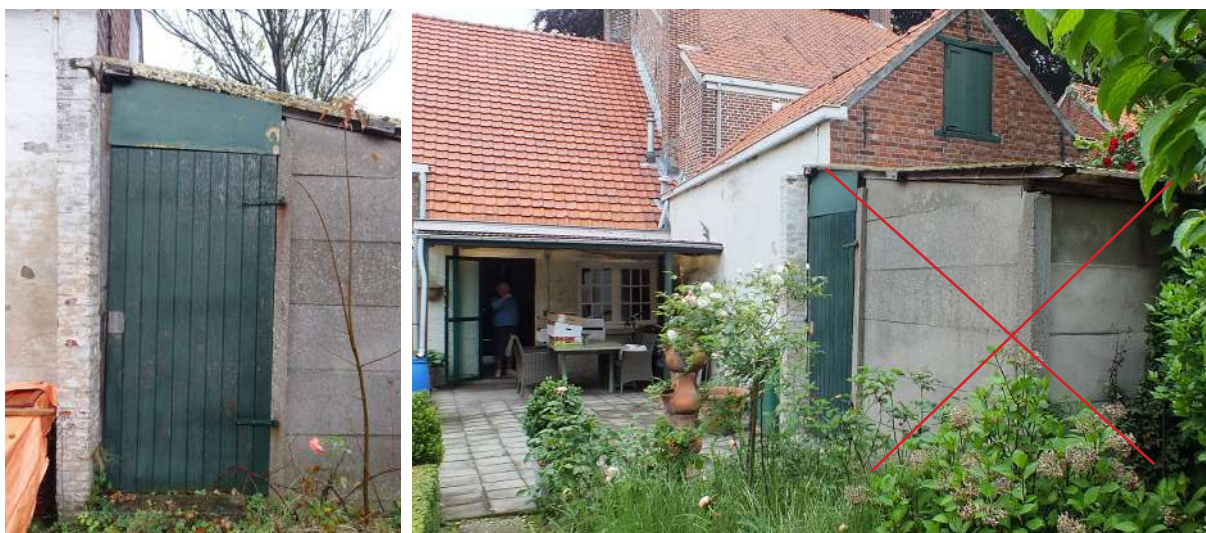
afb. 54: Betonnen aanbouwsel: huidige toestand 2023 en 2016.
