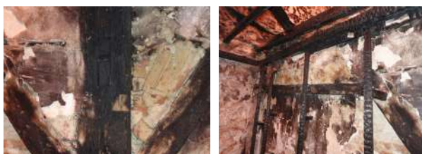
afb. 77: Opkamer, restanten vakwerkbouw: toestand december 2023.
