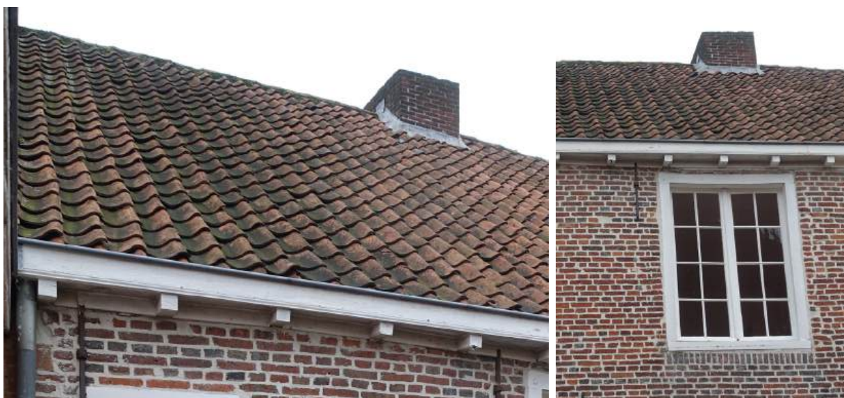
afb. 71: Bedaking achtergevel nr. 20: details, huidige toestand maart 2024.
