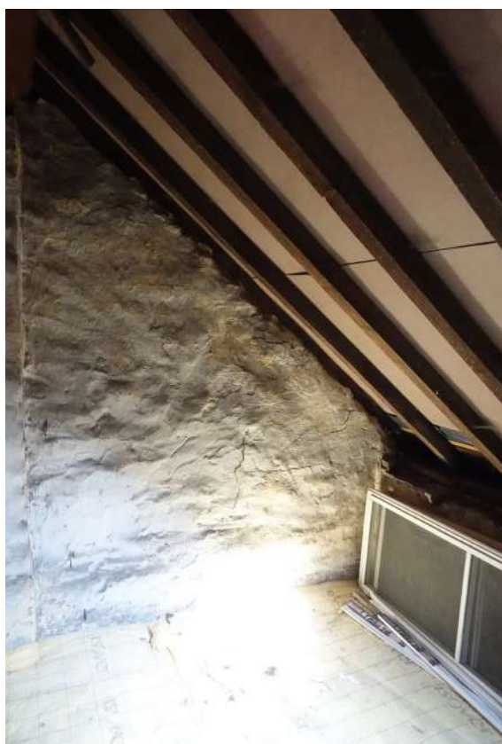
afb. 91: Barsten in pleisterlaag, scheidingsmuur (zolder).
