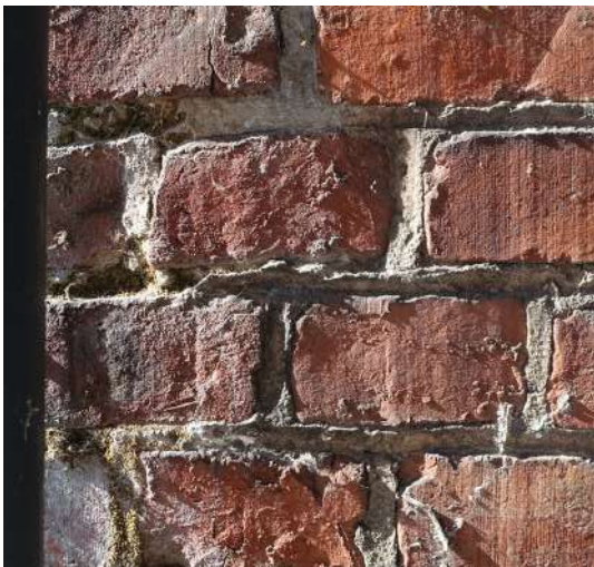
afb. 63: Plaatselijk uitgespoeld voegwerk, voornamelijk ter hoogte van de bouwnaad, achtergevel.
