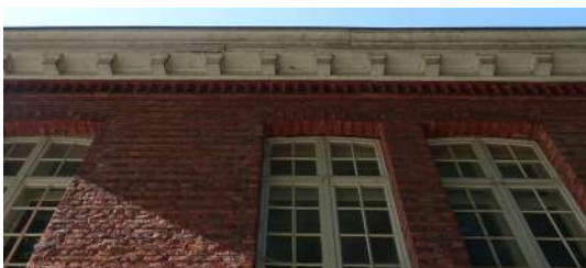
afb. 67: Plaatselijke afschilfering verflaag kroonlijst
