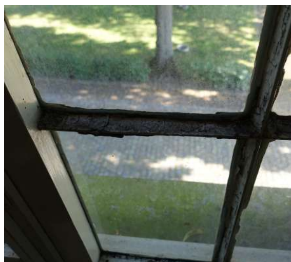
afb. 85: Afschilferende verflaag op ijzeren glasroeden (verdieping).
