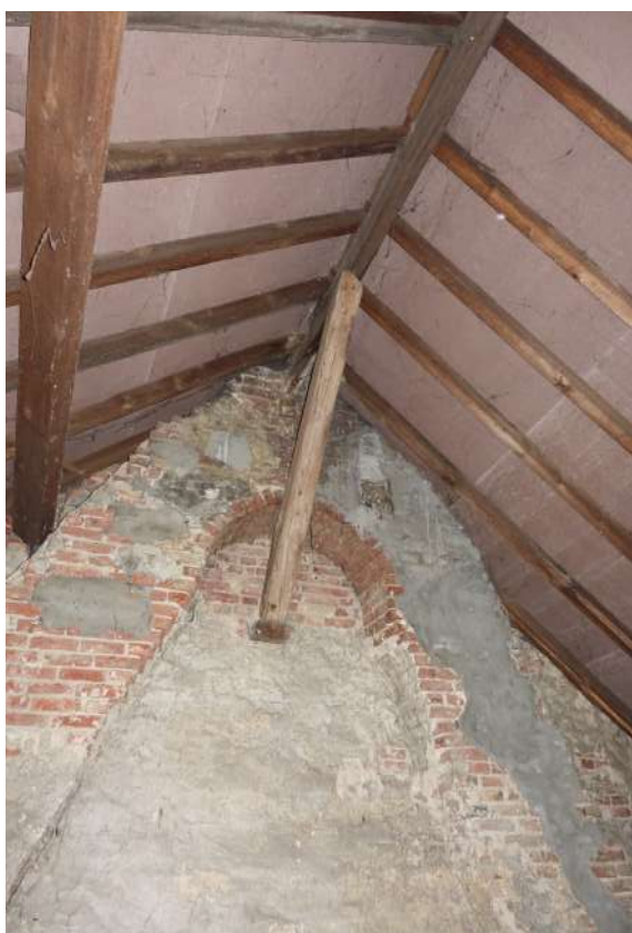
afb. 90: Beschadiging aan de wandbepleistering en cementopvullingen (zolder).
