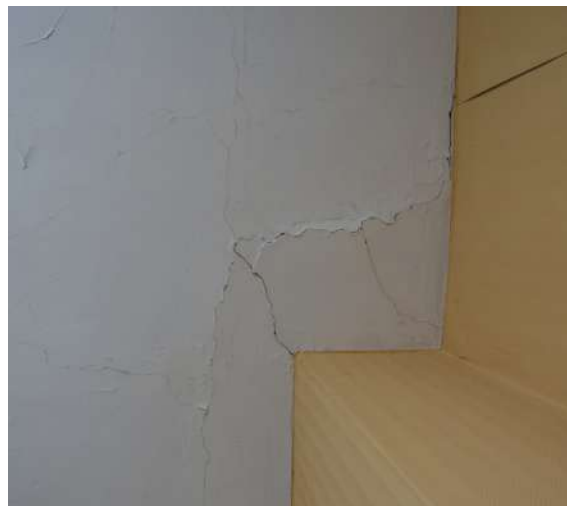
afb. 83: Scheuren in pleisterlagen (verdieping).
