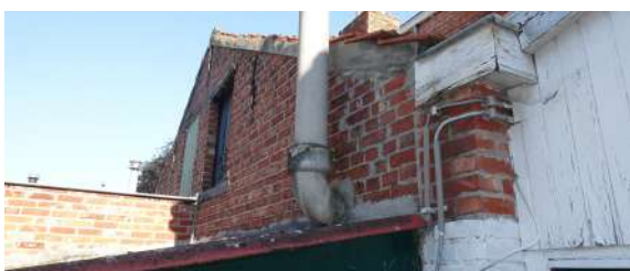
afb. 73: cementvoegwerk + verschaalde verflaag schrijnwerk
