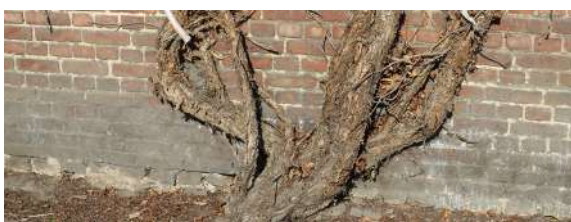
afb. 72: Uitgespoeld voegwerk aan plint (zijgevel).
